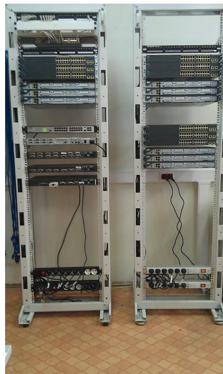
Телекоммуникационные стойки с оборудованием
